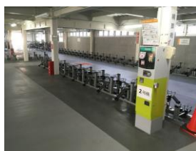
電磁ロック管理システム
