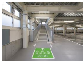
自転車搬送用コンベア
